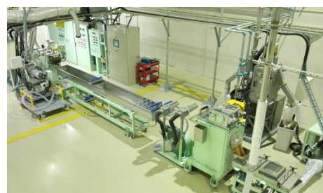
コンパウンド設備（岡山工場）
