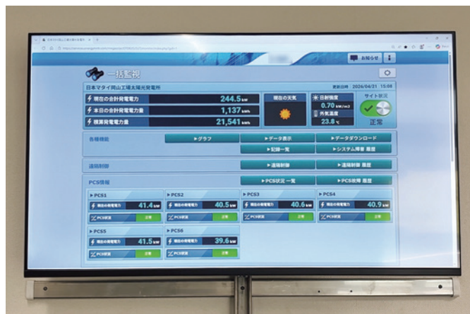
発電状況を表示するリアルタイム監視モニター
